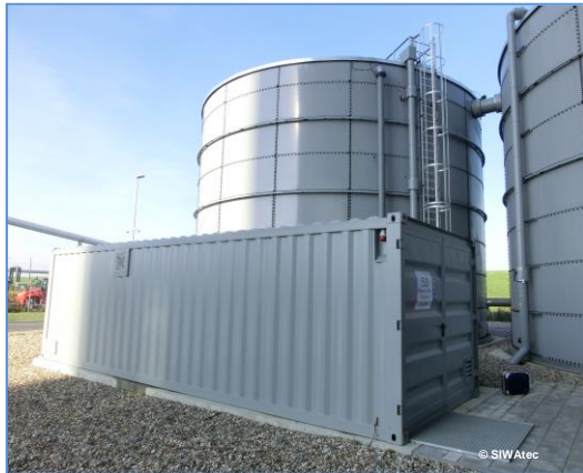
Container mit 2 x 1000 m 3 Vorratstanks
