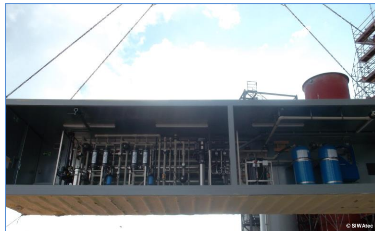
40' Teilcontainer mit Kesselspeisewasseraufbereitung
