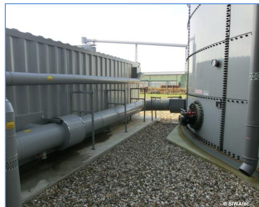
Container-Anbindung an bestehende Anlage
