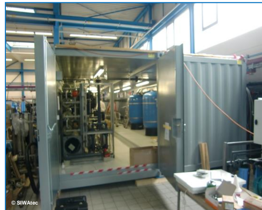
Doppelcontaineranlage beim Funktionstest
