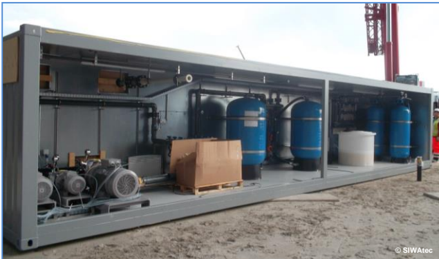
40' Teilcontainer mit Vorreinigung Kesselspeisewasser
