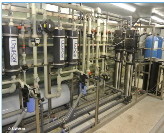
2 x 9 m 3 Kesselspeisewasser im 2 x 40' Container
